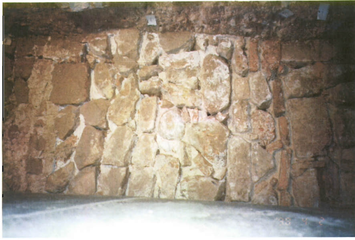
FOTO 2. Alçat del parament del mur del Palau un cop repicat l'arrebossat a l'indret on va obrir-se el pas de comunicació. Detall de la tècnica constructiva.
