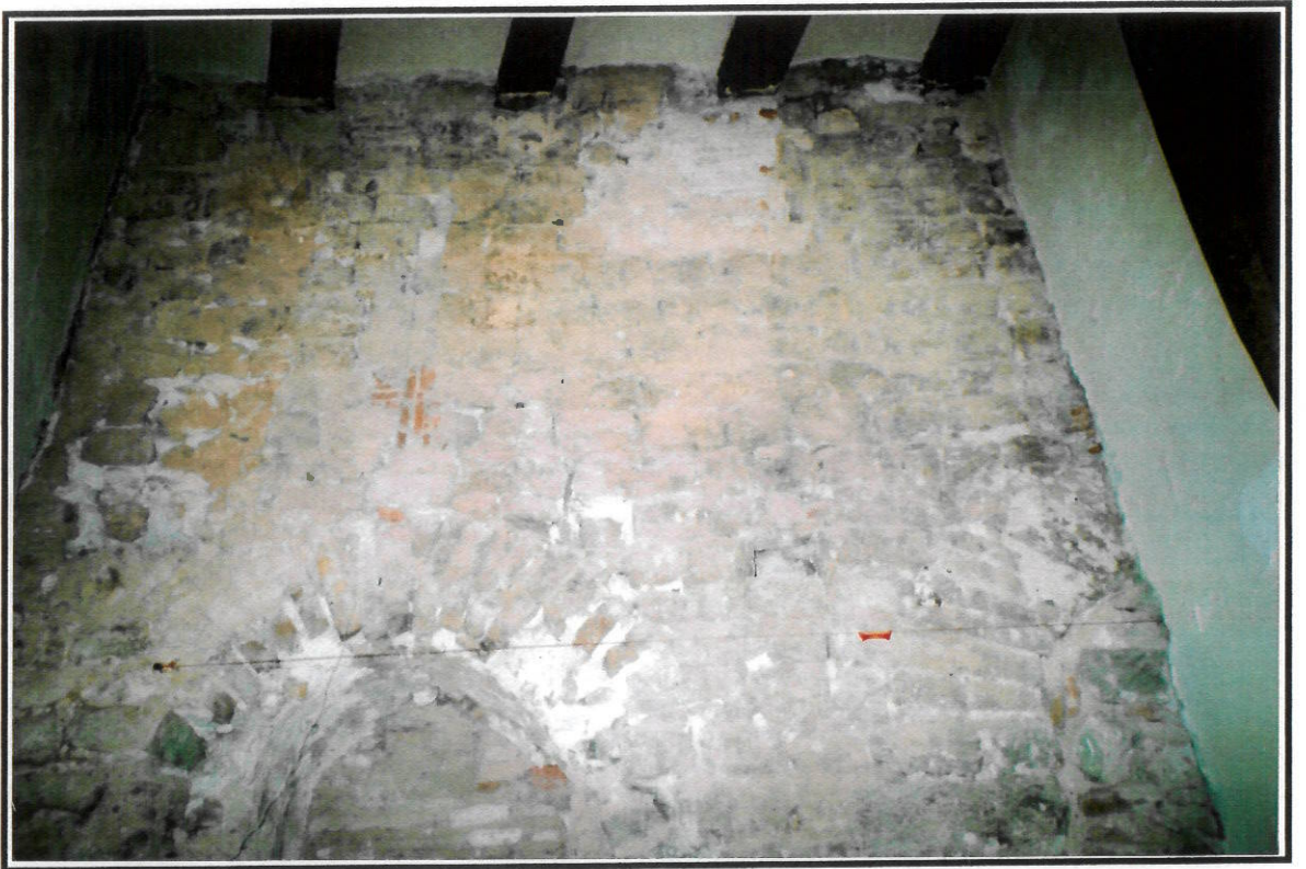
F. 5. Vista general de l'alçat del mur oest de la torre romana 67. S'hi veuen les dues finestres d'aquesta paret. Des del petit dormitori de l'immoble actual.
