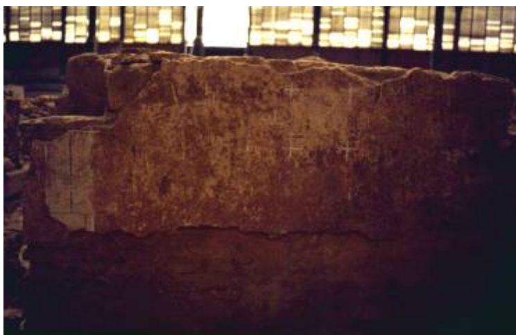
Catas de limpieza en revestimientos. Tras varios encalados aparecen restos de la decoración original.
