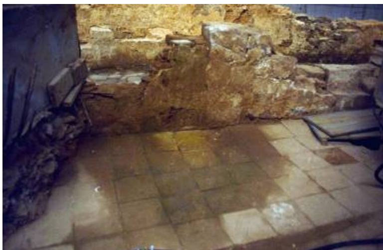
Erosión y ataque biológico producido por una gotera.
