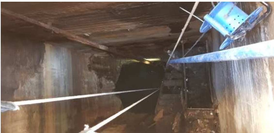
Fotografia 2. Imatge de l'interior del pou. Es poden veure les restes d'una escala, les dues bigues laterals que sustentaven el muntacàrregues i un accés a un altre espai. Autoria: Mossos d'Esquadra.
