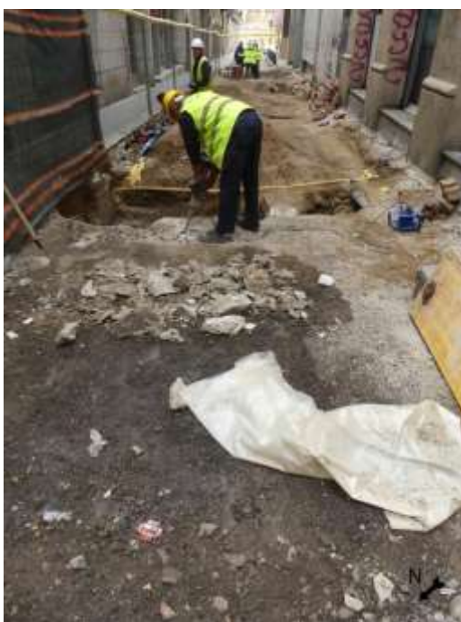
Imatge 1. Imatge del procés d'excavació del paviment actual al Carrer de L'Est.
