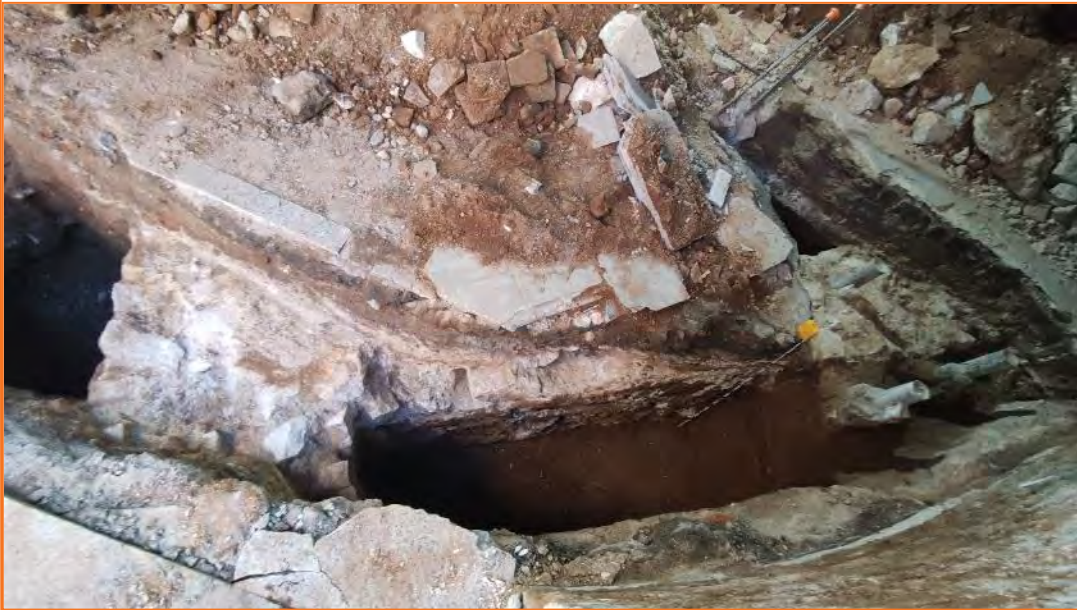
Foto 37. Vista de la fonamentació UE 36 a la riosta entre P.6 i P.13.
