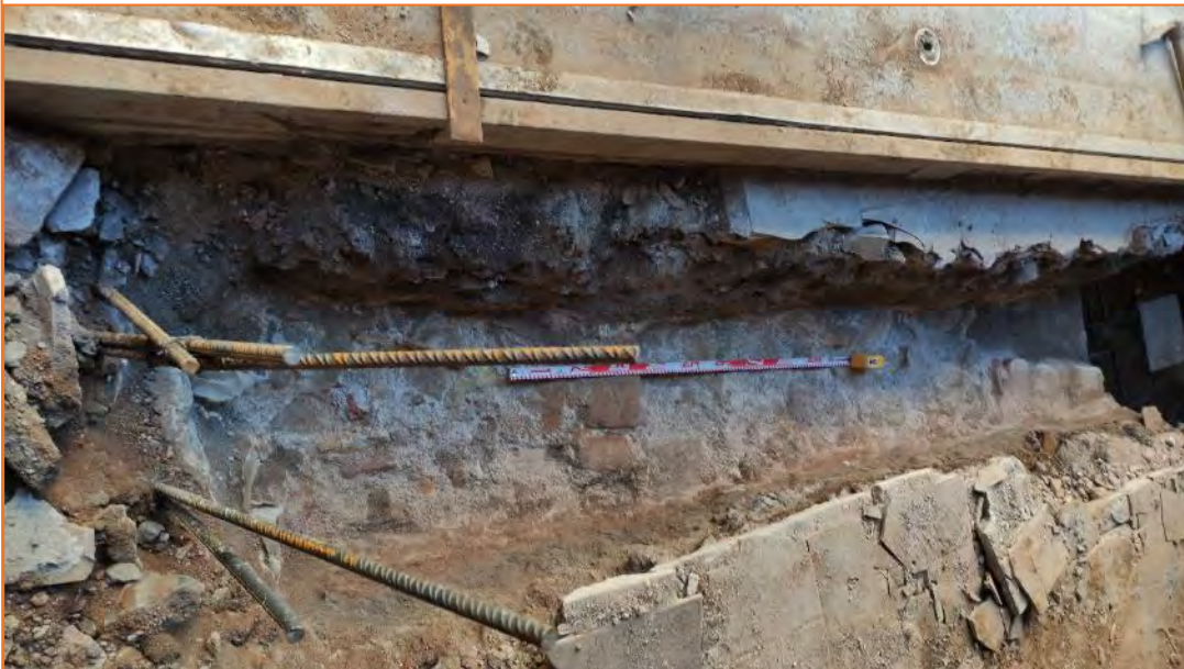
Foto 38. Vista de les fonamentacions UE 18 i UE 36 a la riosta entre P.13 i P.18.
