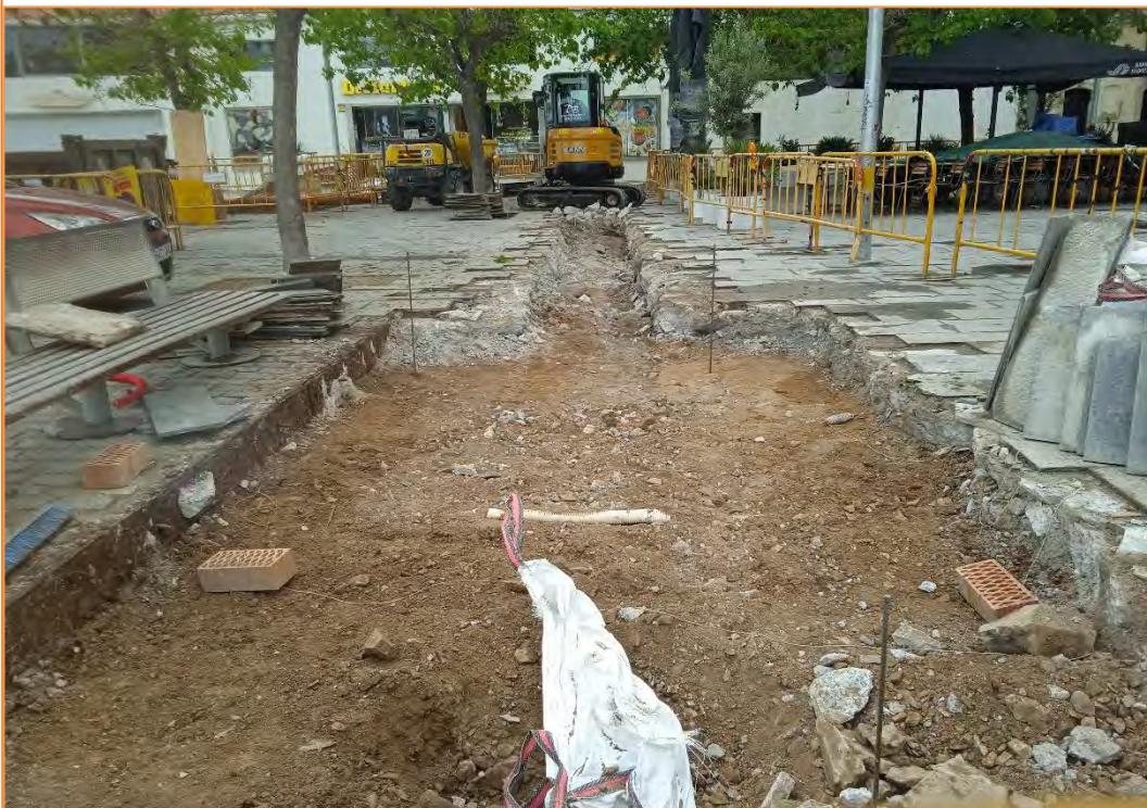
Foto 6. Vista del calaix de la cabina amb UE 2.
