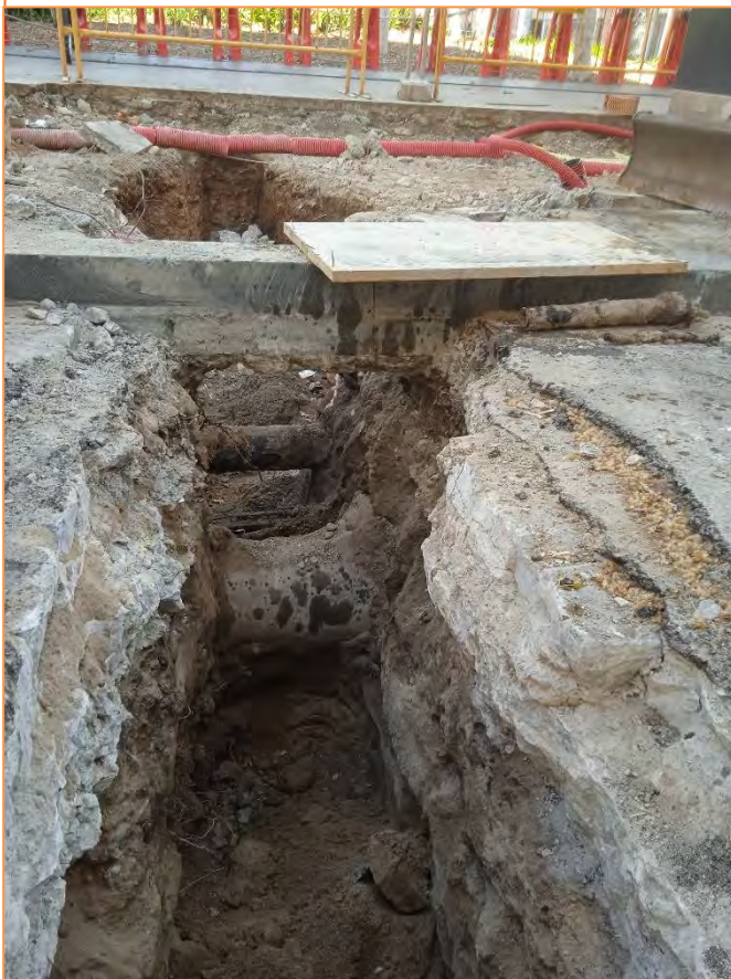
Foto 22. Rebaix de l'anivellació UE 7 amb l'aparició dels serveis del carrer de Sant Carles.
