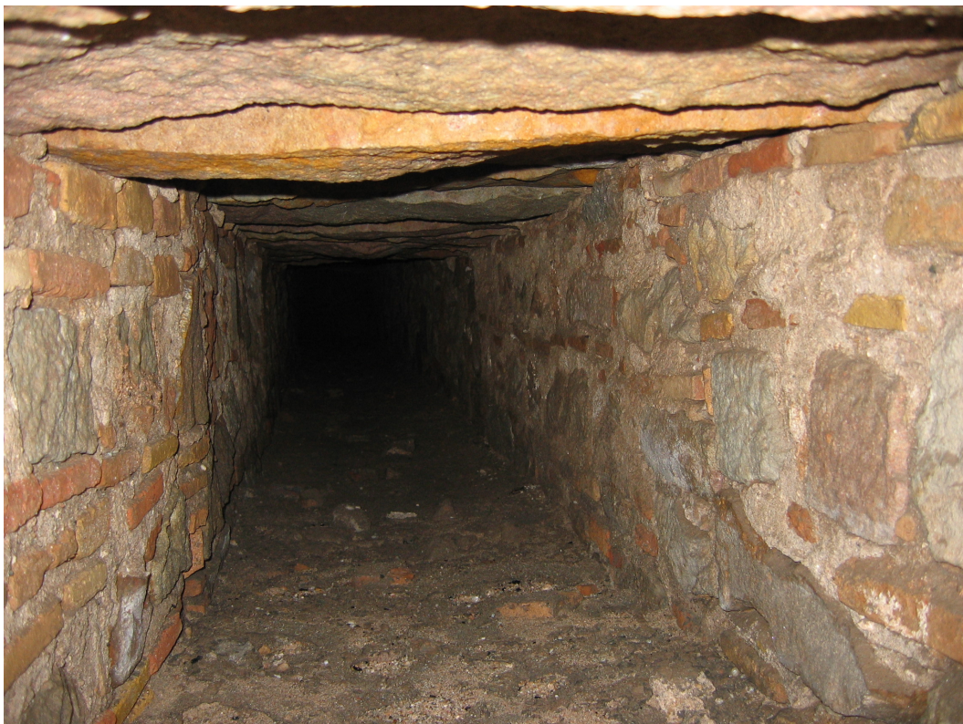
Imatge 12. Vista interior de la canalització, on es pot apreciar l'obra de les parets en maçoneria mixta i la coberta realitzada amb lloses de pedres rectangulars.
