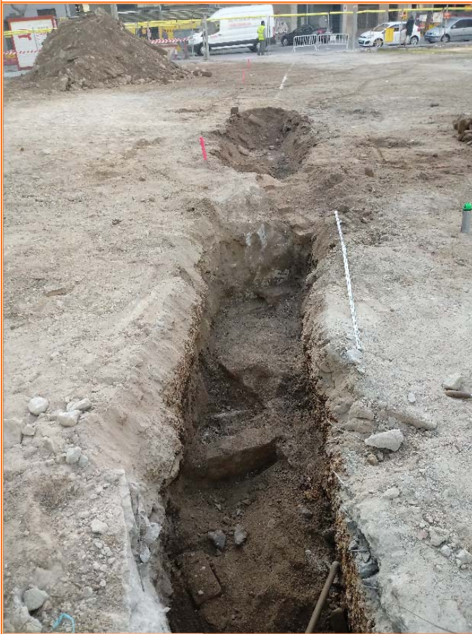
Foto 3. Vista de les UE 2 i 7 durant l'excavació de la rasa de RSU.
