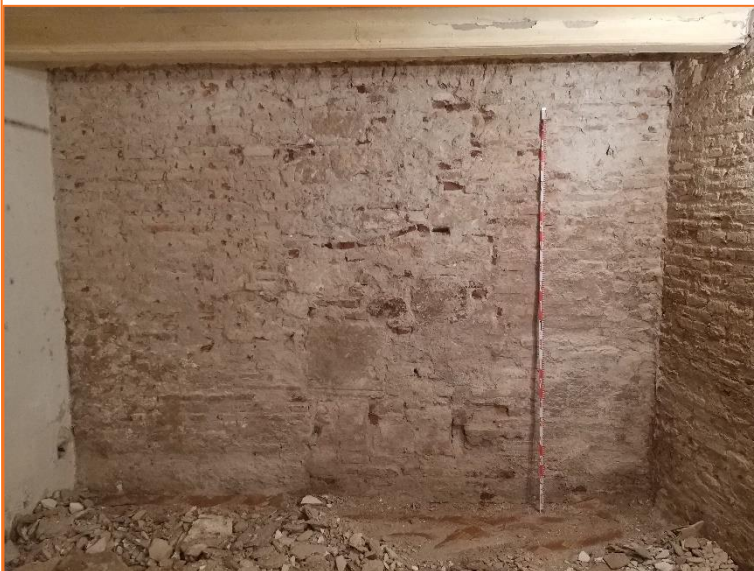
Foto 26. Vista del repicat de la paret oest del local.
