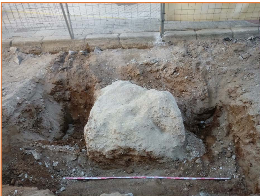
Foto 16. Foto en planta del bloc de ciment de funció indeterminada, un cop rebaixat a cota d'afectació de l'obra. Fase II.
