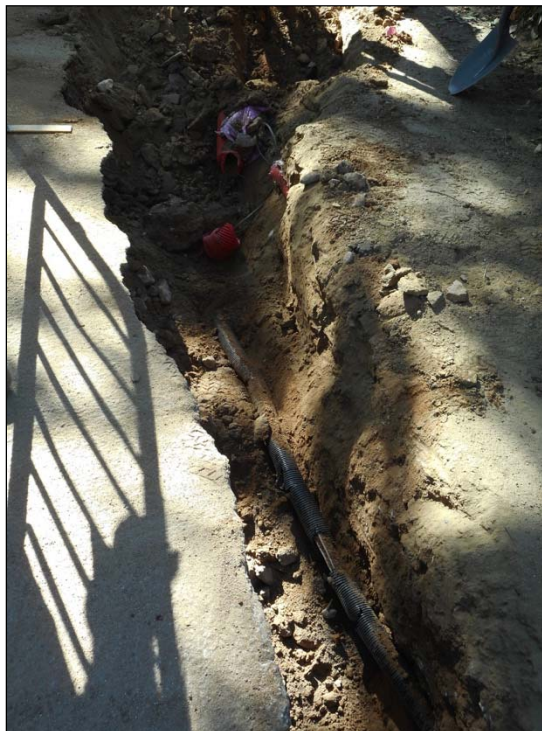
21. Localització de serveis d'aigua i llum al tram de la Gran Cascada.
