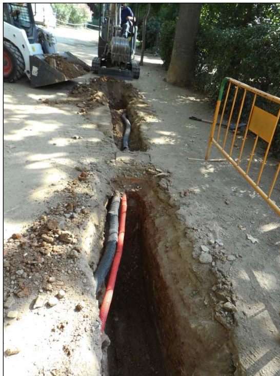
29. Localització de serveis d'aigua i llum al tram de la Gran Cascada.
