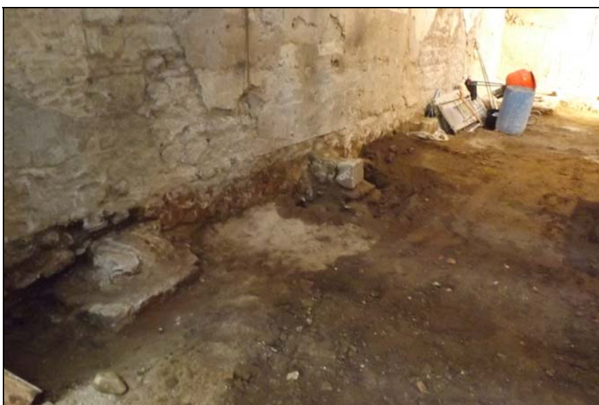
Vista del contrafort UE 143 en primer terme i vista general de l'element amb relació als altres elements apareguts en la fase anterior de la intervenció
