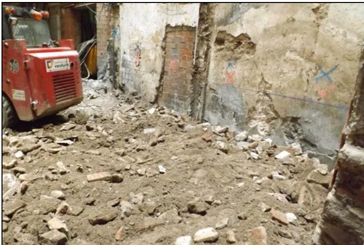
Vista general de la zona a excavar la rasa de la Trava 10
