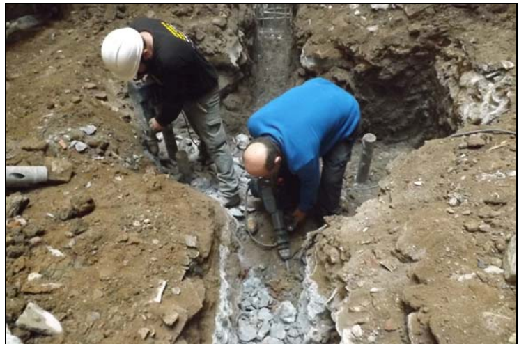
Afectació del planxé de formigó
