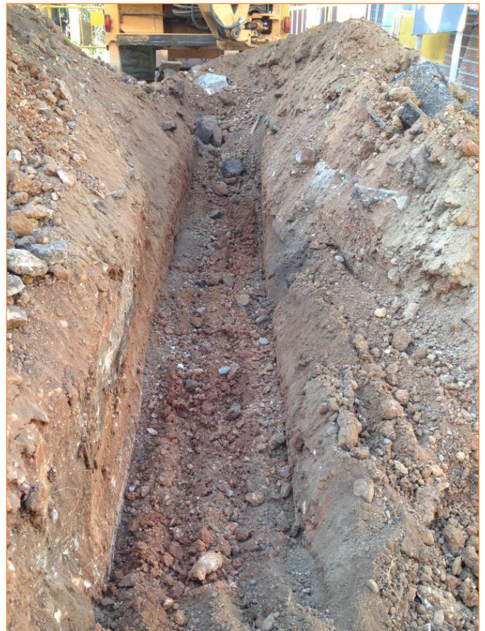
Foto 6. Estat final de la rasa paral·lela a la línia elèctrica
