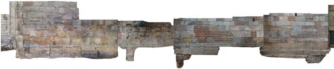
Tram del sòcol, fonamentació i llenç inferior de la muralla, entre la torre 12 i 14.
