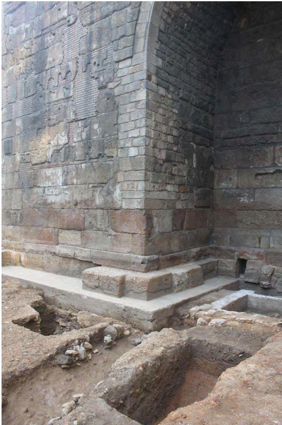
Parament de la torre 15 amb les obres posteriors efectuades al segle XIV que van refer bona part de l'aresta nord i el parament nord-oest. (Artigues. 2016)
