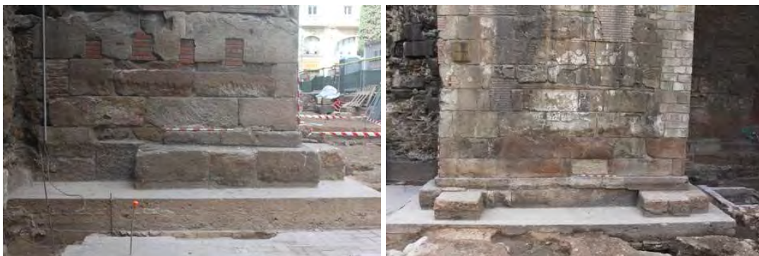
Cara de llevant i nord de la torre 15, on es veu el reforç de la fonamentació feta en la dècada del 40
