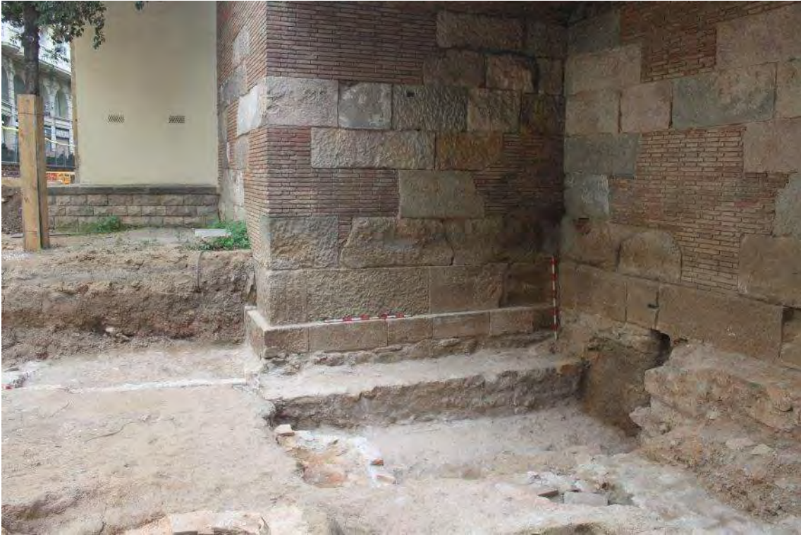
Alça de la torre 9 on podem veure el reforç de la fonamentació. (Artigues. 2015)
