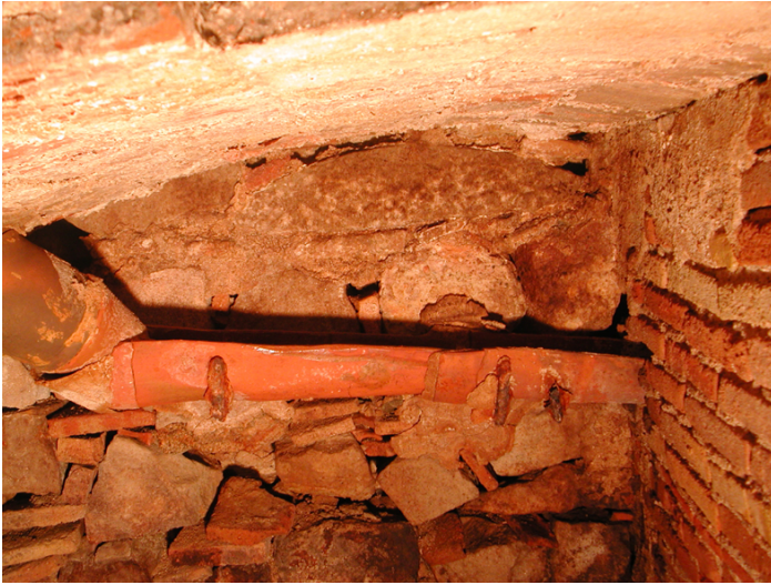
Detall de la canalització UE 114, per sota de la volta, i la connexió amb la claveguera UE 117.
