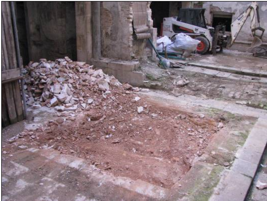
Paviment i solera del safareig parcialment picat.
