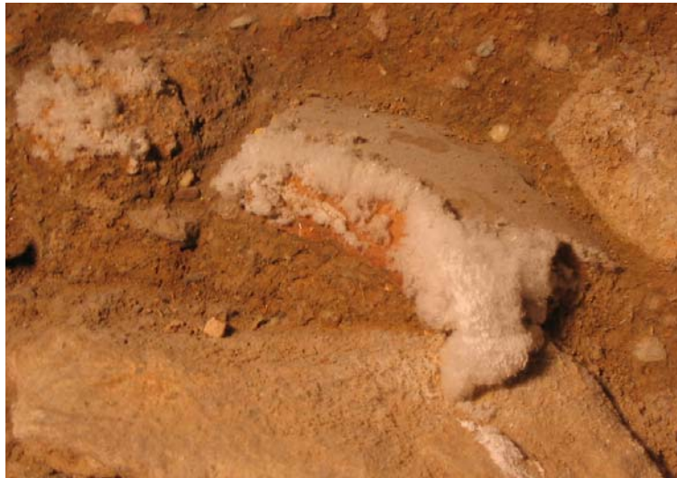
Mur alt imperial, (U.E. 9206), presència d'eflorescències de sals solubles de manera generalitzada
