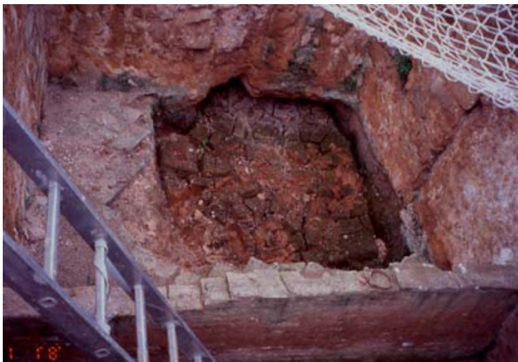
U.F.417. Moment després de la filtració de bentonita
