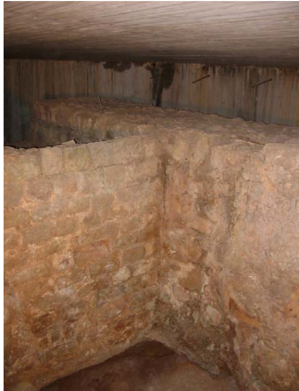
Filtracions localitzades en la zona propera a les UF. 416-417
