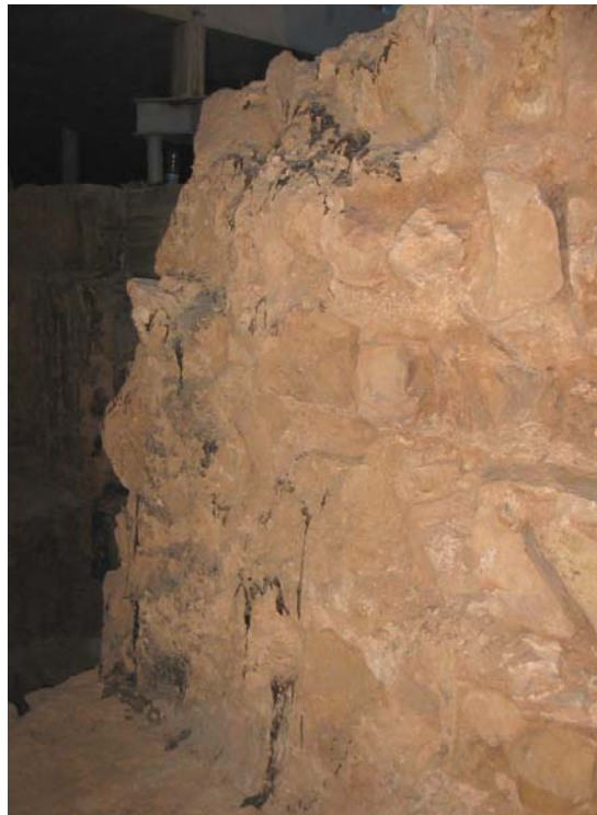
Restes de plàstic cremat, molt adherit a les estructures
