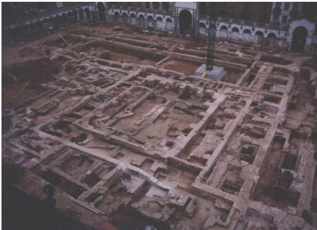
Vista parcial de l'excavació, durant el procés d'excavació, ja desmuntades les fonamentacions del mercat i les fases més modernes del convent. Al mig es situa el claustre gòtic i a la seva dreta, l'església. (Fotografia núm.8272)
