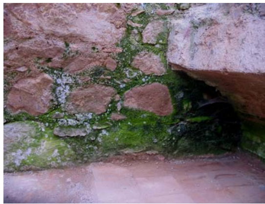
Estat de l'arrebossat interior dels nínxols
