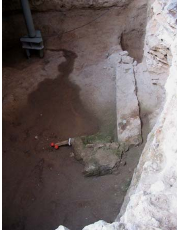
Detall de la U.F. 385, s'observen les filtracions d'aigua com la proliferació de l'atac biològic
