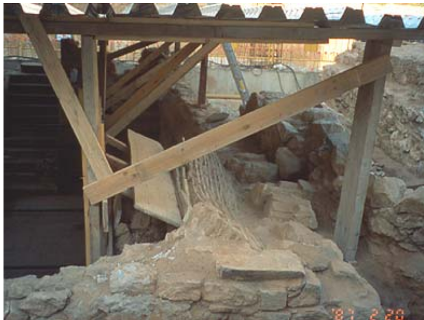
Detall del sistema d'apuntalament de l'arrencament de la volta conservat. Es crea una estructura amb taulons, puntals de fusta i de ferro
