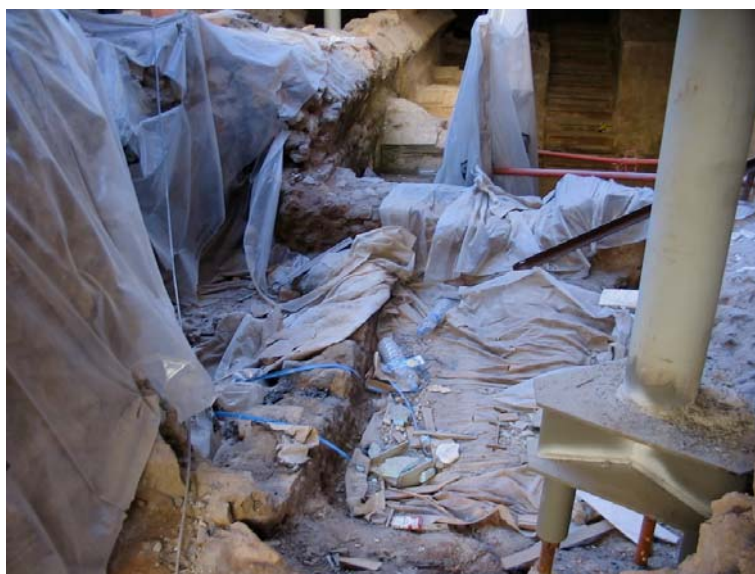
Deixalles de tot tipus acumulades en punts a on les estructures fan de receptacle
