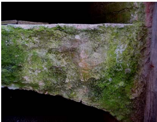
Estat de l'arrebossat exterior dels nínxols
