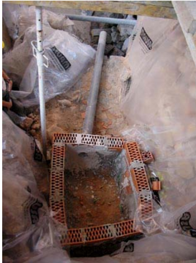
Sistema de canalització de l'aigua i el ciment a una zona de fàcil eliminació, prèvia col·locació d'uns plàstics per anar-lo recollint
