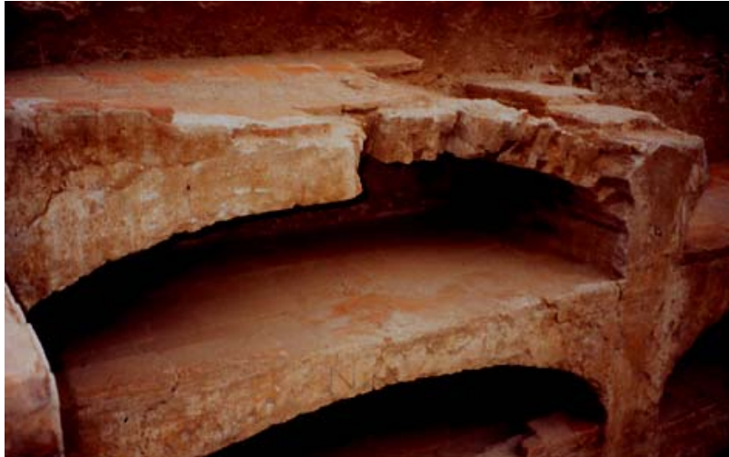
Estat d'una de les voltes dels nínxols, a on s'observa la fragilitat de l'estat de conservació
