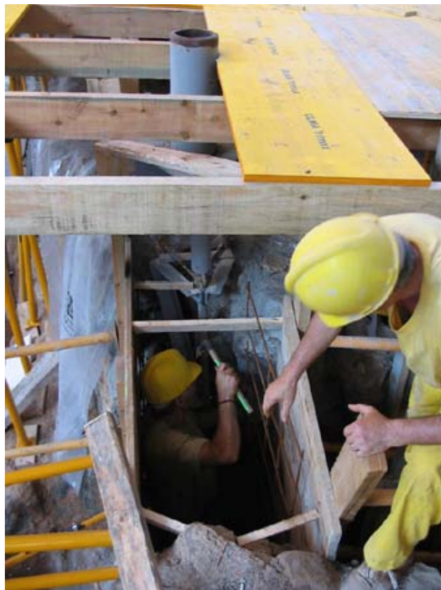
Moment de la col·locació de la malla metàl·lica en l'encofrat de fusta
