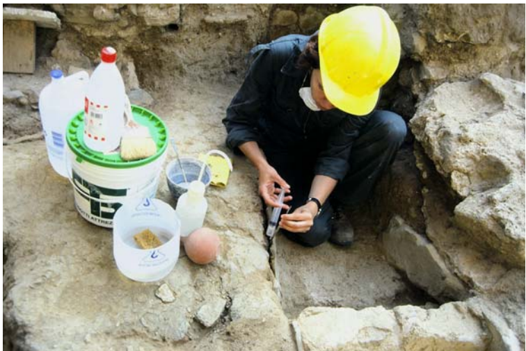
Preparació de la superfície a treballar i fixació dels arrebossats de la U.F. 386, Edifici VII, necròpolis antiguitat tardana
