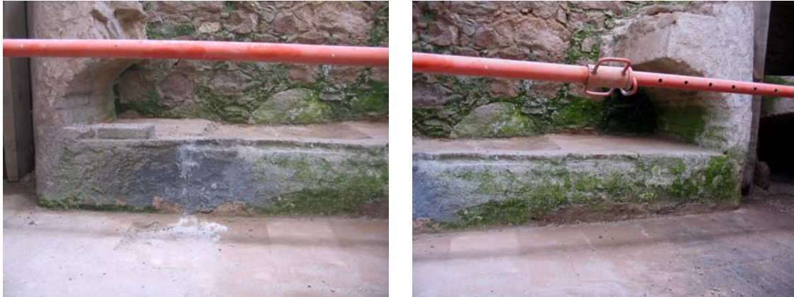
Estat del nínxol després de l'escolada de ciment en la construcció de la coberta del mercat
