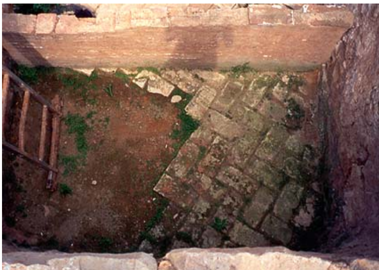
U.F. 416, atac biològic general, disgregació arrebossats i rajoles incompletes
