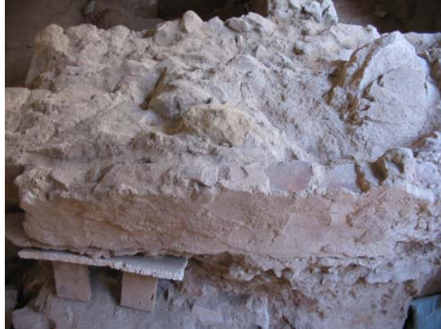
Edifici VII. Detall de les fissures en el morter aplicat
