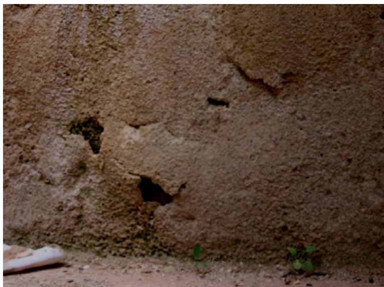
Detall dels arrebossats de la part interna dels nínxols
