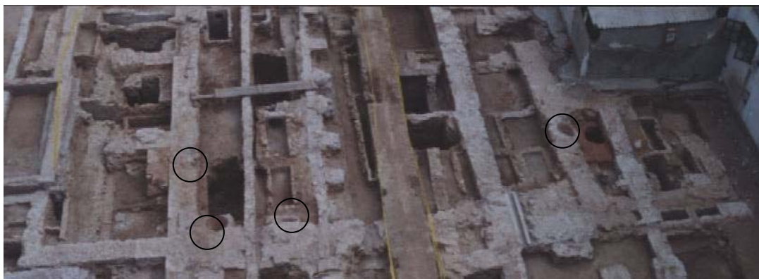
Situació dels contenidors, dos a la fonamentació de la façana i un a la primera capella de cada costat.
