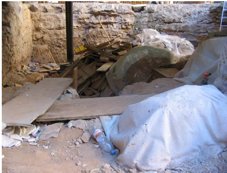
Presència de deixalles de les tasques de desencofrat, així com brutícia generada per l'obra de la construcció del Mercat
