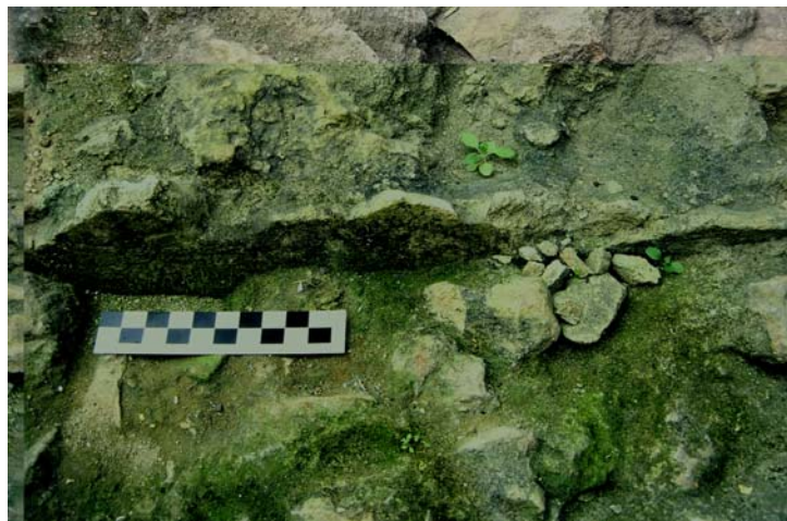
Detalls del despreniment de part dels arrebossats així com contorns malmesos de l'exterior de l'Edifici VII
