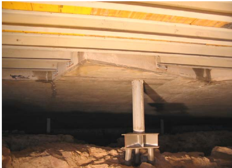
Filtracions d'aigua els dies de pluja de manera puntual
