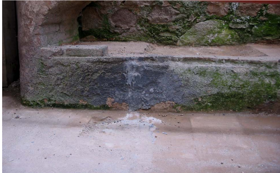
Ciment que prové de la construcció de la coberta del mercat, cripta U.F. 326. Es troba molt adherit als morters dels arrebossats, cosa que fa pensar que la data de creació de la cripta està totalment perduda
