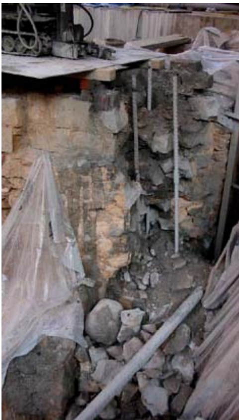
Estat després de l'ensorrament
