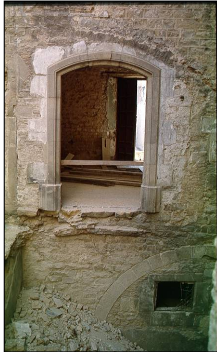
Foto 22: Vista d'un dels paraments de l'edifici del Pati d'en Llimona on s'hi observen diverses refeccions
