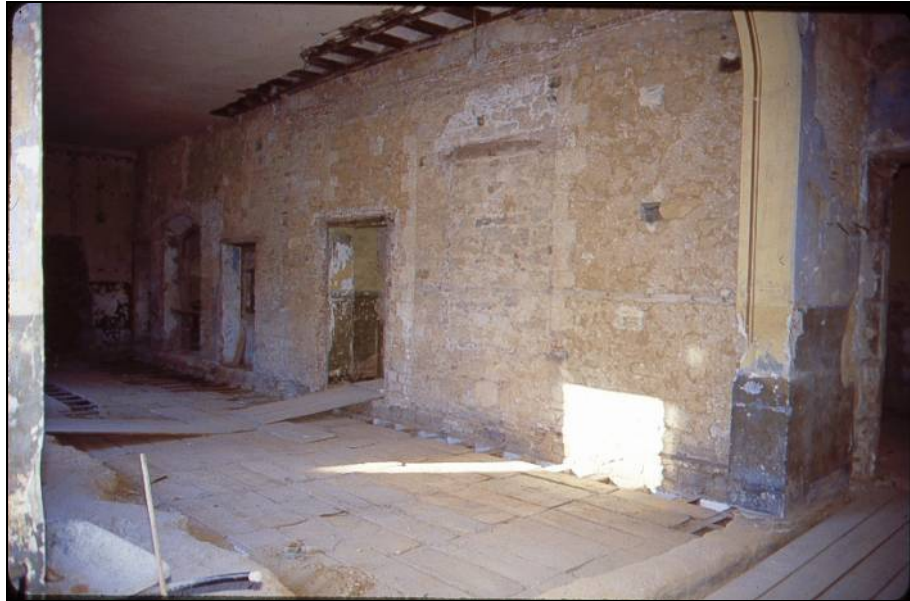
Foto 18: Sala noble de la primera planta del casalot d'origen gòtic del Pati d'en Llimona. Podem observar les fustes originals que configuren la base del paviment entre biga i biga
