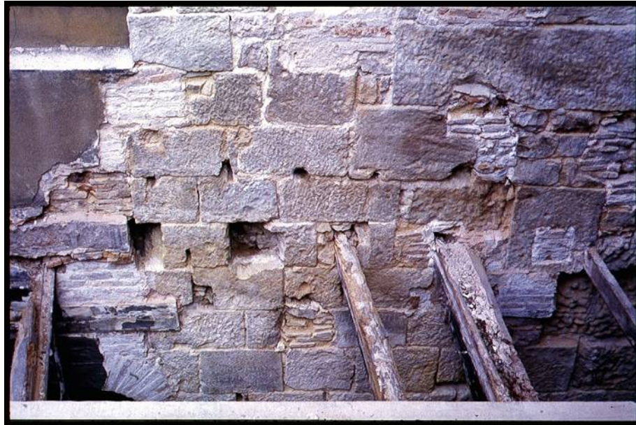
Foto 13: Vista de com les estructures contemporànies afectaren el parament de la muralla romana baiximperial. En aquest cas, els forats per insertar els caps de biga.
