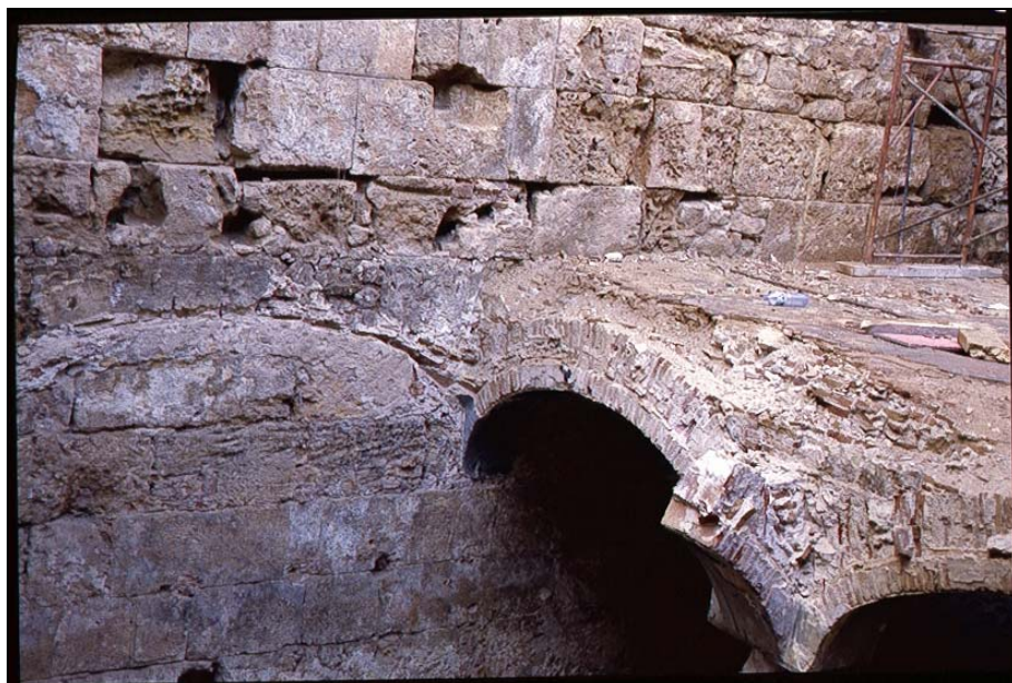
Foto 12: Vista de com les estructures contemporànies recolzaven directament sobre el parament de la muralla romana baiximperial afectant-lo
