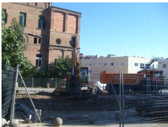
Vista NO-SE de la situació del rebaix, amb el pavelló de Sant Antoni al fons
