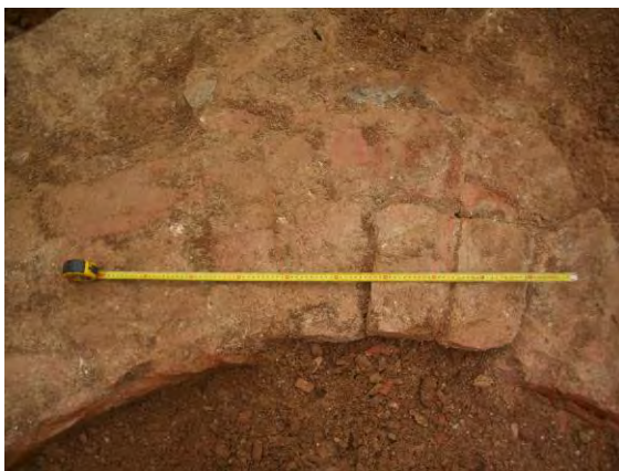
Detall del sistema constructiu de la bassa, amb els maons ceràmics disposats radialment
