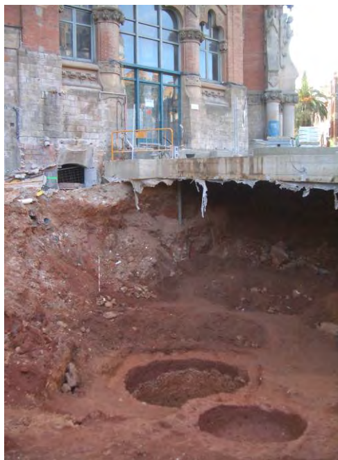
Situació de les sitges ue 1008 i 1009 respecte l'edifici d'Administració i el túnel
