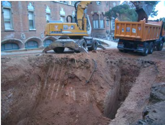
Vista SO-NE del rebaix, amb el pavelló de la "Mare de Deu de Montserrat" al fons
