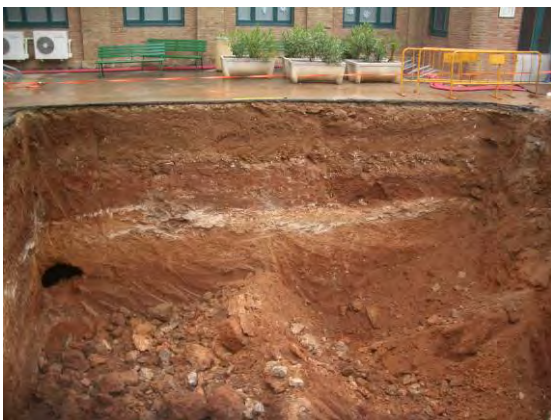
Perfil SE del rebaix, amb les argiles naturals a 1.4 m de l'asfalt i el passadís soterrani ue 816 a baix a l'esquerra
