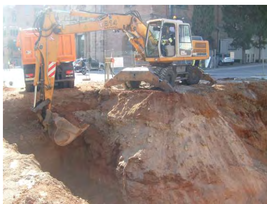
Zona NE del rebaix, on s'observa el terraplenament de runa
