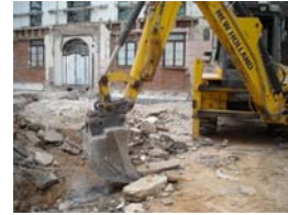
DSCN0277 Afectació paviments
