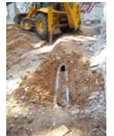
DSCN0364 Tub que espolia el paviment 1013
