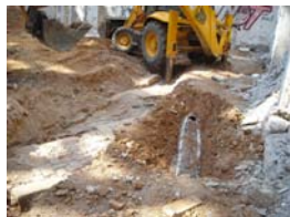
DSCN0366 Afectació Tub
