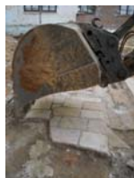
DSCN0481 Afectació paviment u.e. 1013
