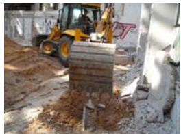
DSCN0365 Afectació Tub
