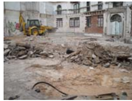
DSCN0271 Afectació paviments contemporanis
