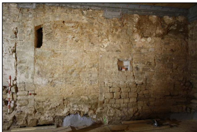
Fotografia 66. Vista del mur de façana de l'Hostal d'en Garcia amb porta d'accés des de l'androna medieval.
