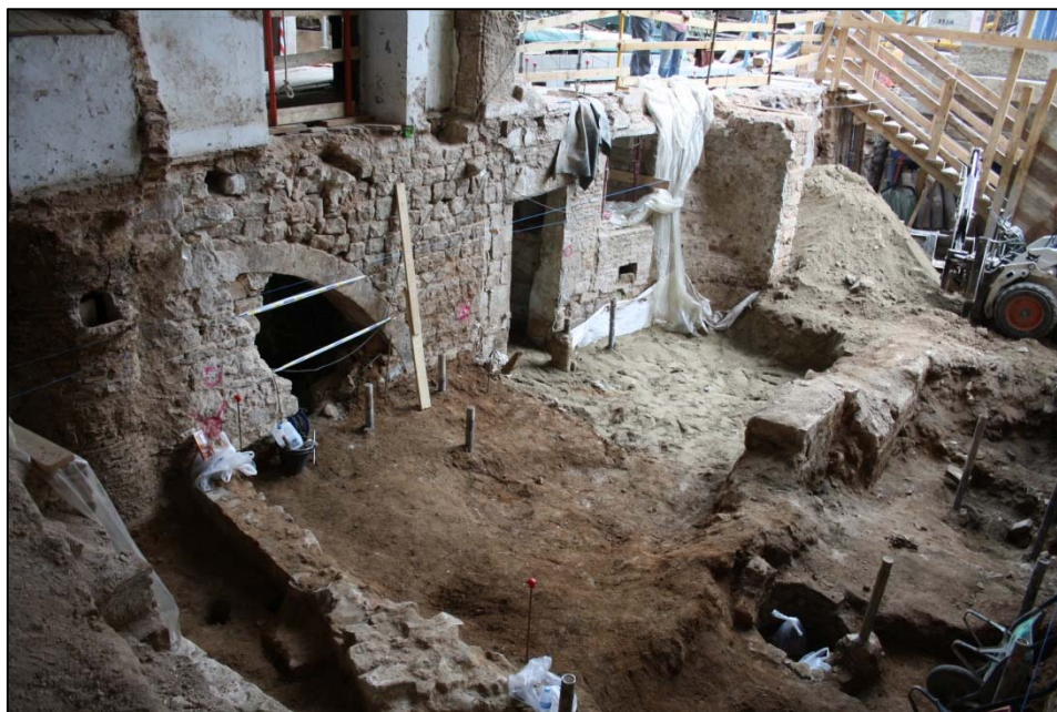
Fotografia 139. Vista general de les habitacions 0.7.1, 0.7.2 i 0.7.3 un cop enderrocats els murs interiors.
