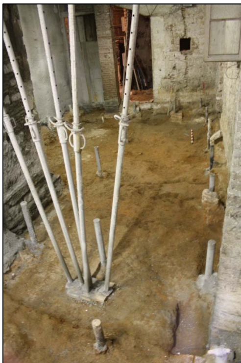
Fotografia 15. Foto final del sector un cop desmuntades les estructures afectades per l'obra.
