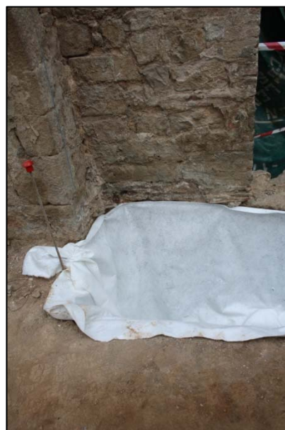
Fotografies 190 i 191. Cobriment i protecció de les fonamentacions dels pilars de l'aqüeducte romà.
