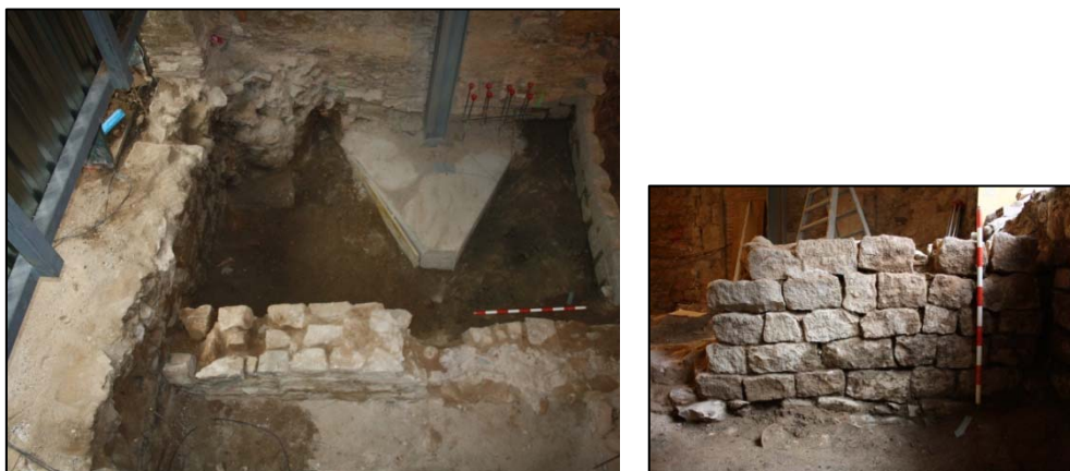
Fotografies 163 i 164. Vista en planta i alçat del mur del segle XV UE791.
