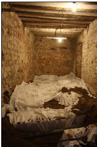
Fotografia 210. Protecció de les estructures excavades l'any 2007 per a la col·locació dels micropilots.
