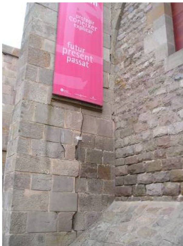
Foto 1. Contrafort de les Drassanes Reials amb evident problemes d'estabilitat estructural.
