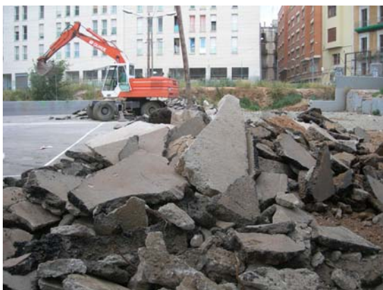
Afectació del planxé de formigó que ocupava els Sectors 2 i 3
