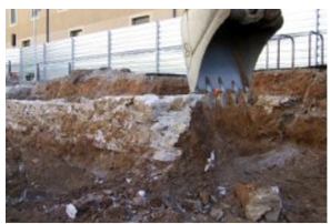
55) Zona A Afectació mur 4013.JPG
