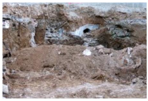
3CF1679 Zona C Afectació.JF
