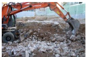
21) Zona B Afectació.JPG
