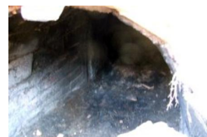
30) Zona B Afectació.JPG
