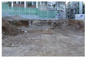
3CF1676 Zona C Afectació.JF
