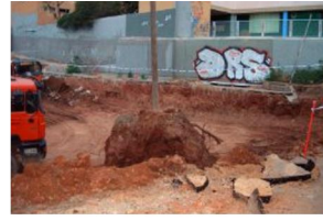
4) Vista cota afectació Sector 3.JPG
