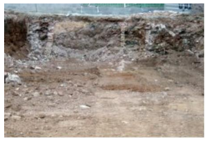
3CF1677 Zona C Afectació.JF
