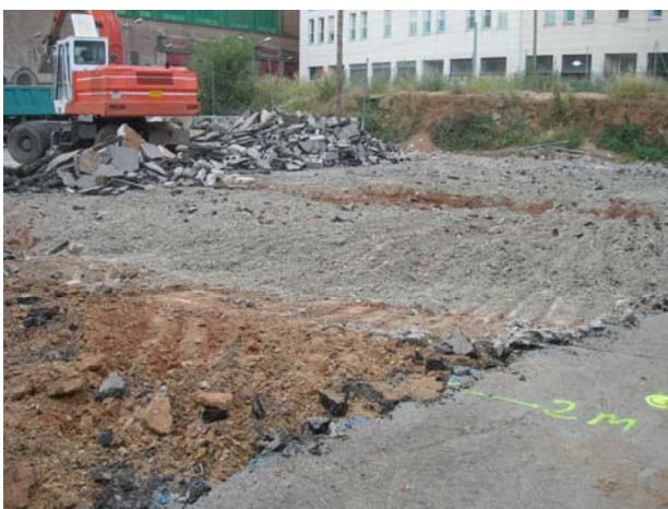
Vista general del Sector 2 amb el rebaix del paviment de formigó i les saorres
