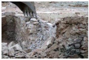
3CF1660 Zona C Afectació.JF
