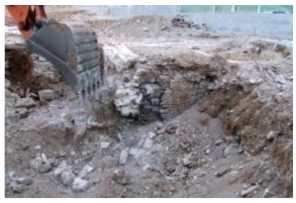
3CF1659 Zona C Afectació.JF
