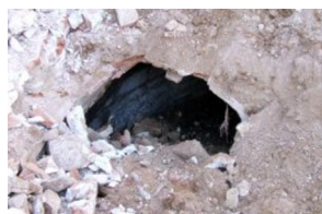
28) Zona B Afectació soterrani.JPG
