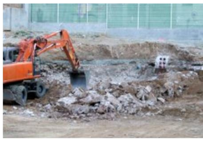
107) Zona B Afectació.JPG
