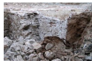
20) Zona B Afectació.JPG
