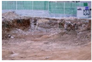
3CF1684 Zona C Afectació.JF
