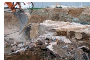
25) Zona B Afectació.JPG
