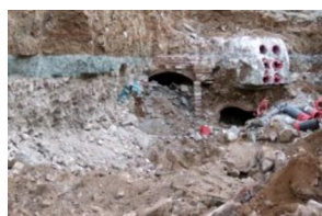
33) Zona B Afectació.JPG
