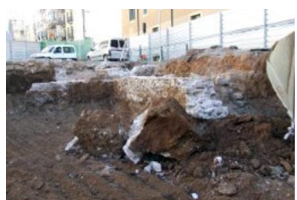
56) Zona A Afectació mur 4013.JPG
