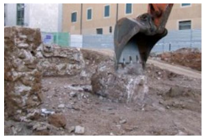
3CF1656 Zona C Afectació estructu
