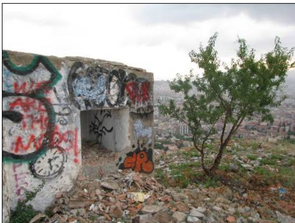
Foto 18: Obertura de la recollida de la baina amb gran acumulació de runa.
