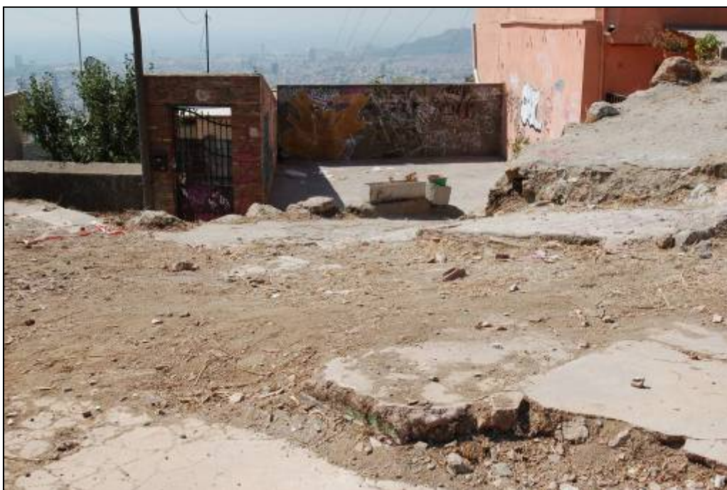
Foto 11: Neteja de l'entrada al complex militar amb les restes del barraquisme.
