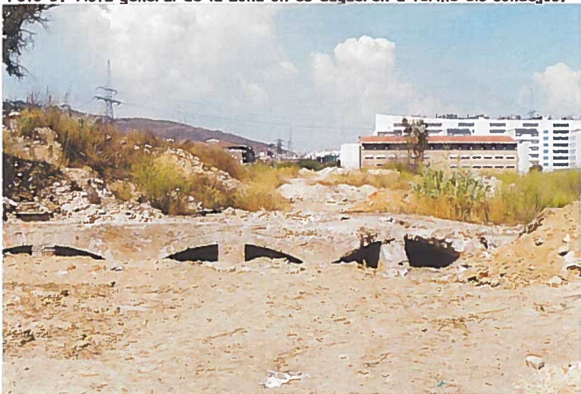
Foto 2. Vista de la part superior del pont de l'enderrocada fàbrica de colorants
