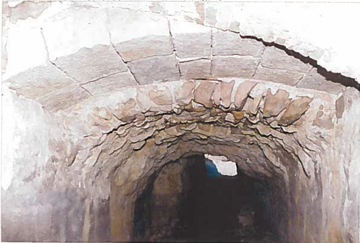
Foto 4. Detall de l'interior del pont, on s'observen l'antiga estructura del carcabà del molí dels segles XV-XVI.
