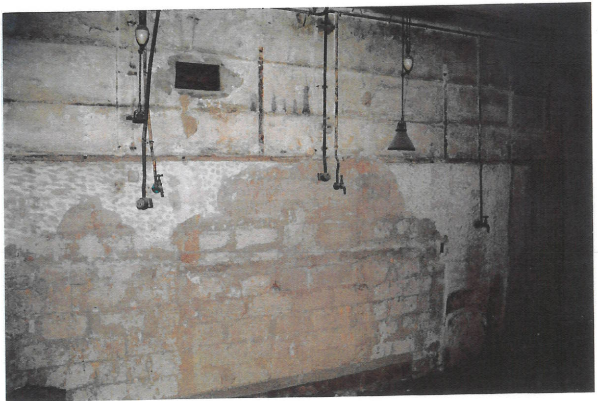
7. Habitació H-2, paret oest on s'observen les restes de les antigues instal·lacions; aixetes, llums, prestatges etc...
