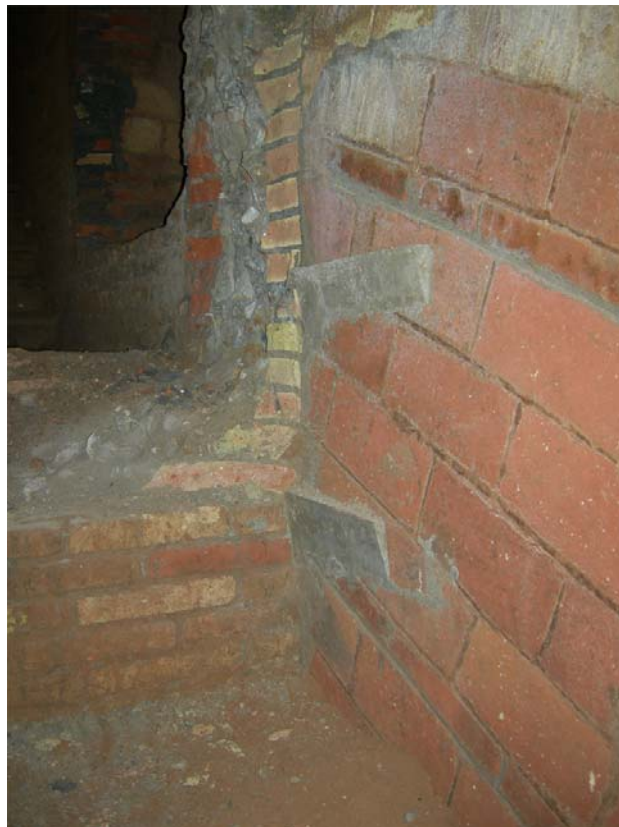
FOTO 44: Entrada accés 3. Suports prestatges
