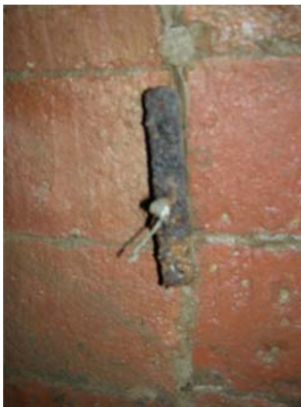
FOTO 96: Entrada-accés 5, suport instal·lació elèctrica
