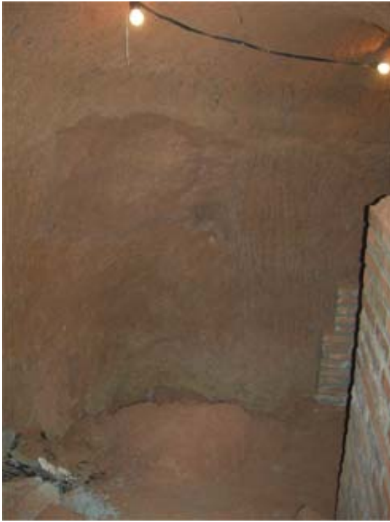
FOTO 119: Tram 9 despreniment modern
