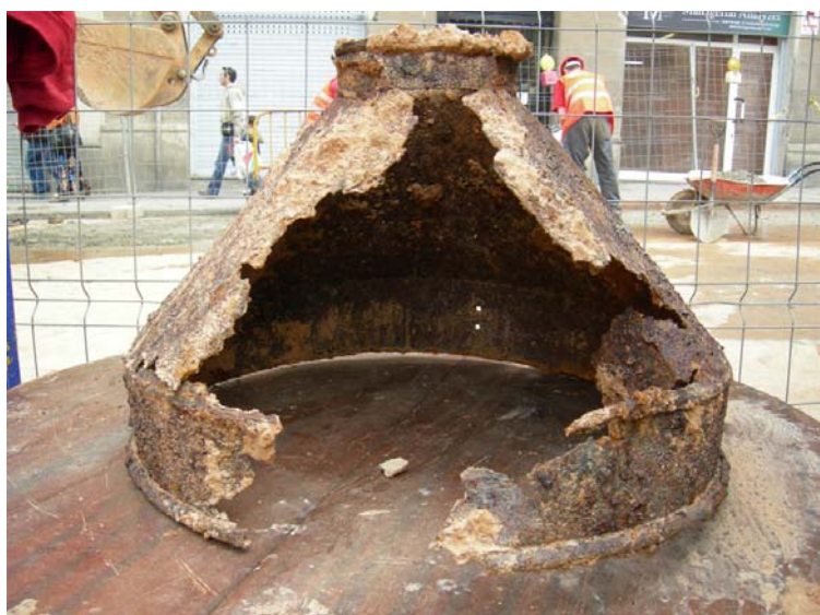
FOTO 59: Tram 8. Campana extractora
