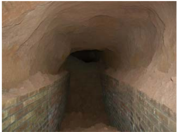
FOTO 100: Entrada 5 despreniments sostre
