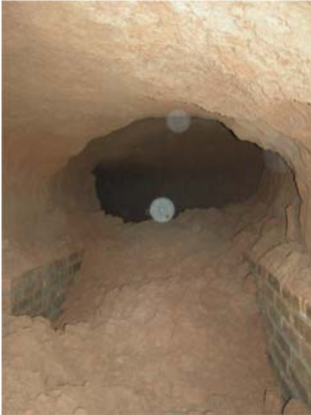
FOTO 103: Entrada 5, ensorrament volta
