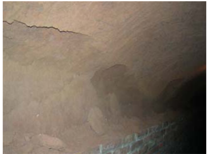
FOTO 124: Tram 9, deteriorització de la
