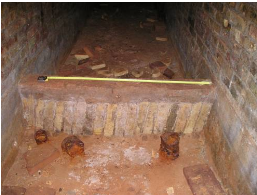
FOTO 33: Tram 7. Estructura precària plec de llibres
