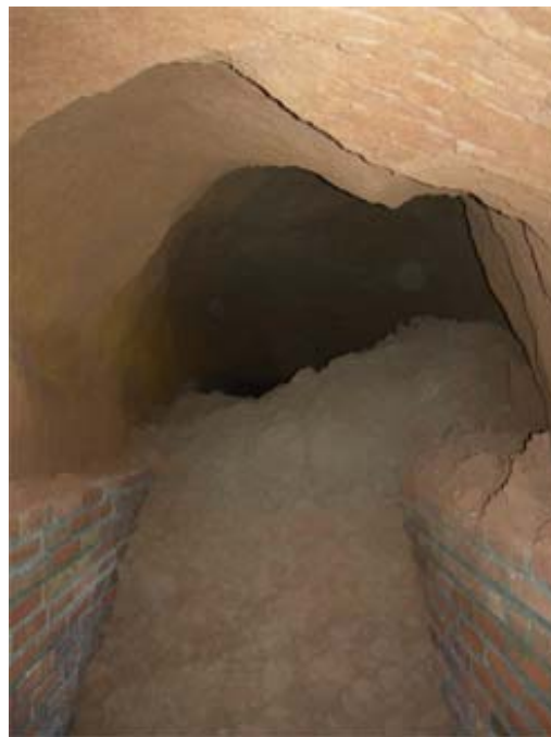
FOTO 122: Tram 9, gran despreniment per ET
