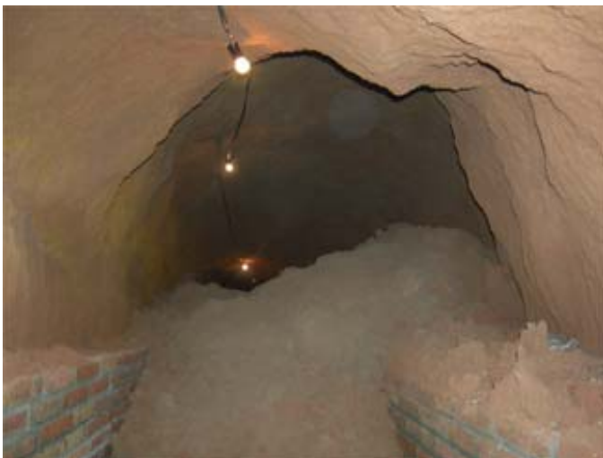
FOTO 121: Tram 9, gran despreniment per ET
