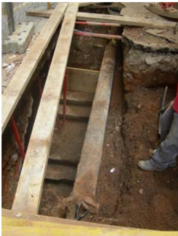
FOTO 83: Entrada-accés 5, conducció d'aigua
