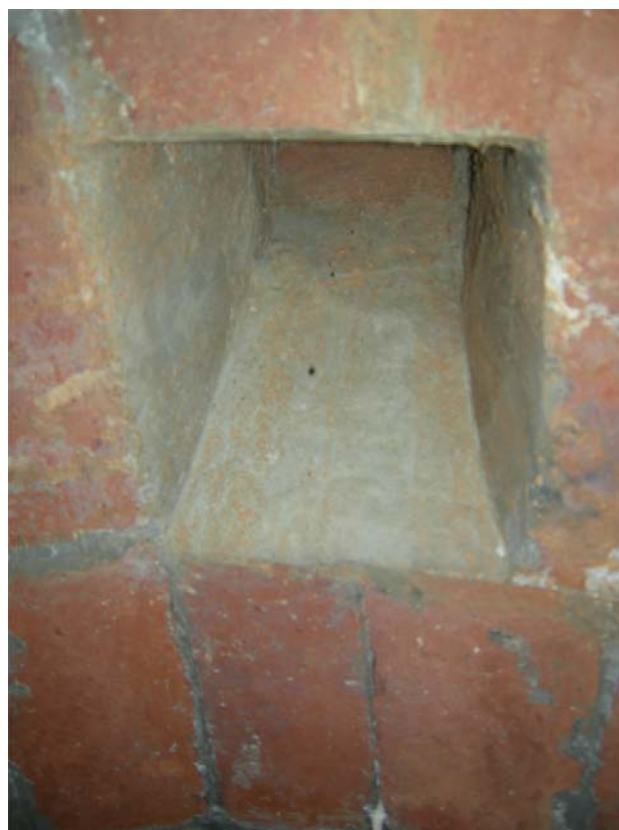
FOTO 60: Tram 8. Forat ventilació ?
